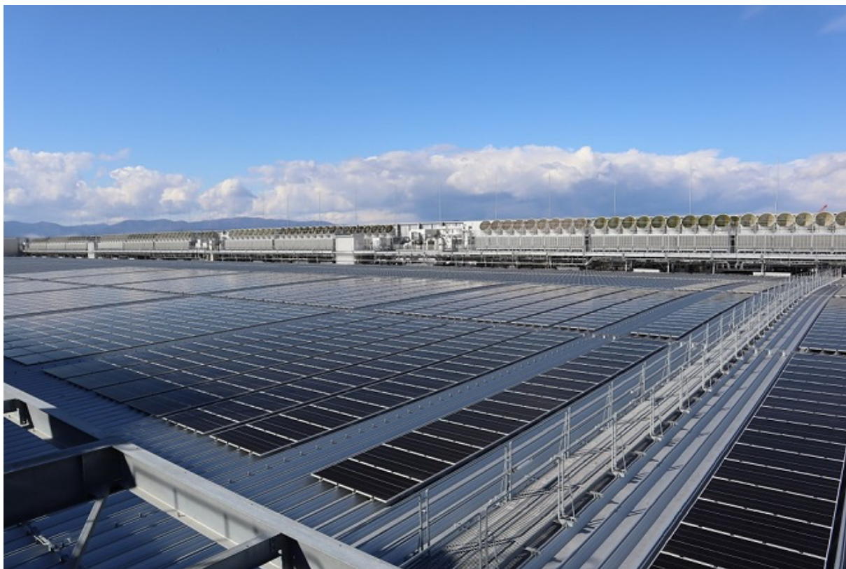
KIOXIA errichtet Solarstromanlagen in den Werken Kitakami und Yokkaichi in Japan
